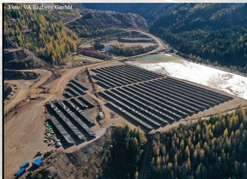
Die neue PV-Anlage auf Etage Palmer im Dezember 2022
